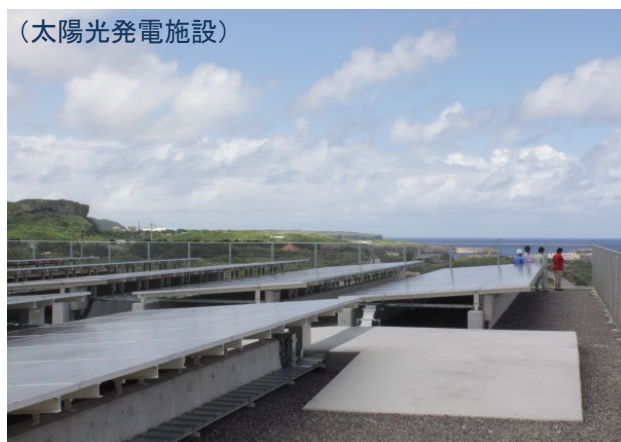
未利用エネルギーの利用施設
